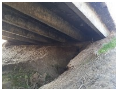
Рис. 3. Размывание подмостового пространства
