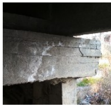
Рис. 5. Горизонтальные трещины насадок
