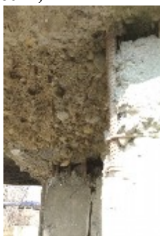
Рис. 4. Выпадение защитного слоя и оголение арматуры
